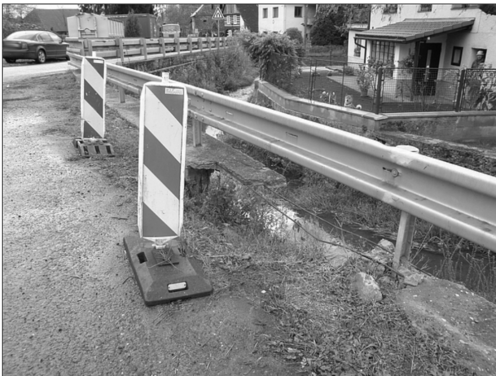
F23 – havarijní stav krajnice
